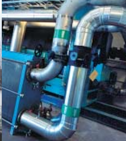
Kylproduktionen vid US har utökats med mer miljöanpassade kylmaskiner.
