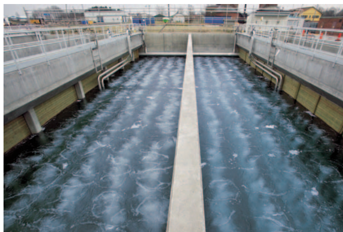
Nya bassängen i reningsverket.
