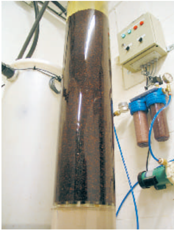
Furubarkfilter som fångar lösta tungmetaller i vatten har installerats på fem tandläkarmottagningar i Linköping. Foto: Hejdlösa Bilder
