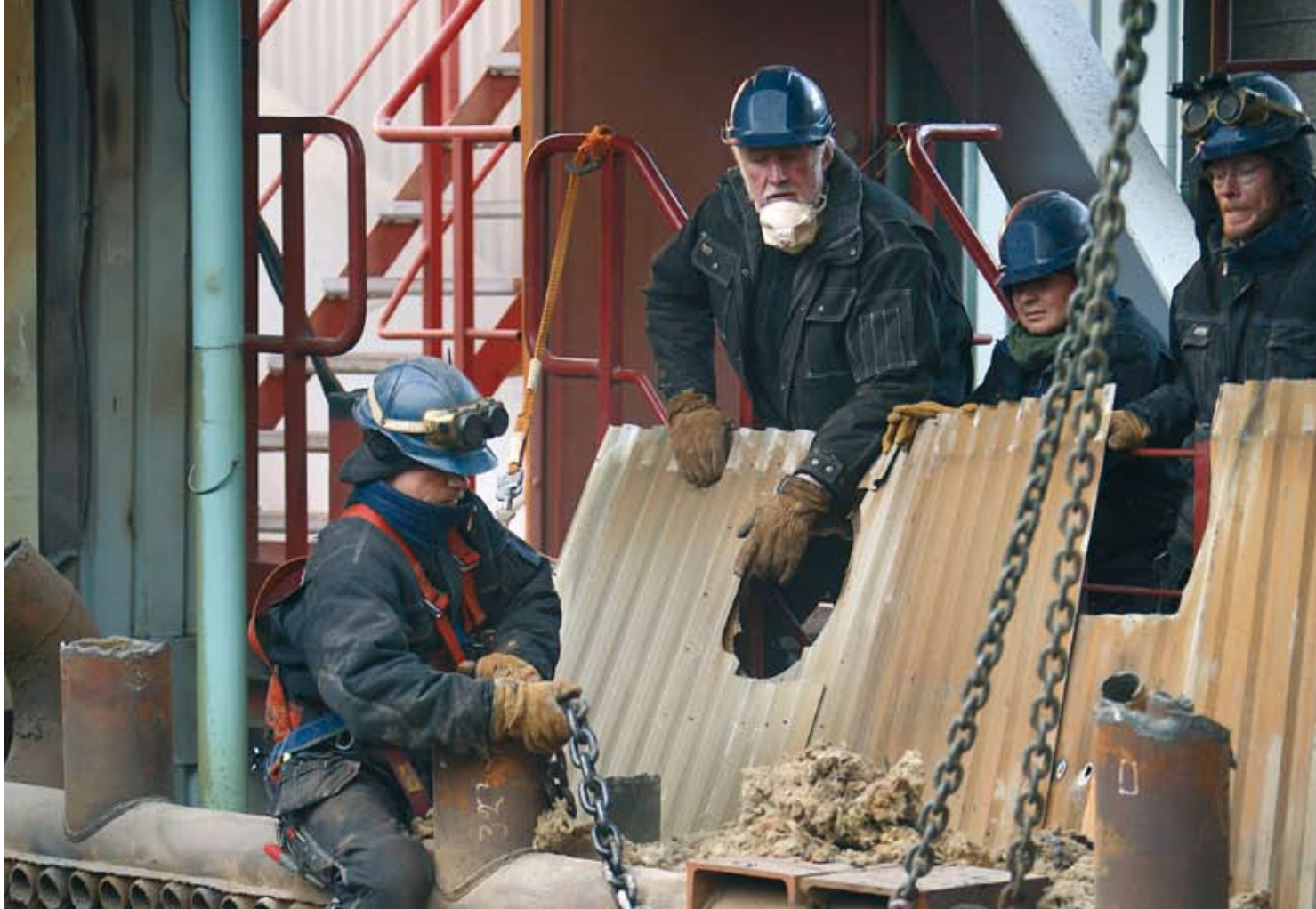
I mars startade rivningen av de två största av de gamla pannorna för avfallsförbränning.
