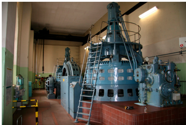
Turbinhallen vid Svartåfors vattenkraftstation
